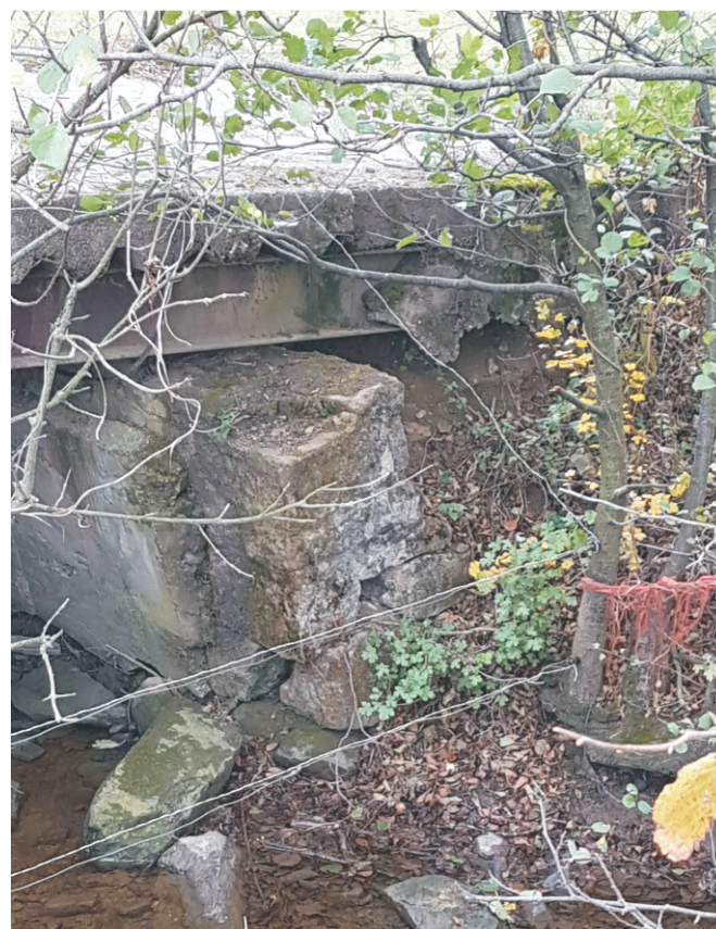
most před opravou
